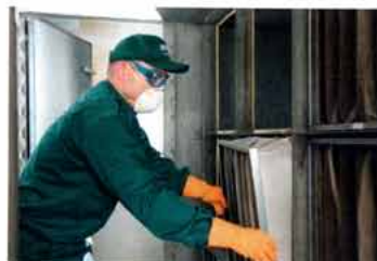
Ausbau verschmutzter Filter
