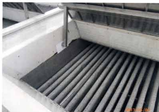
Abluftauslass nach der hygienisch-technischen Behandlung
