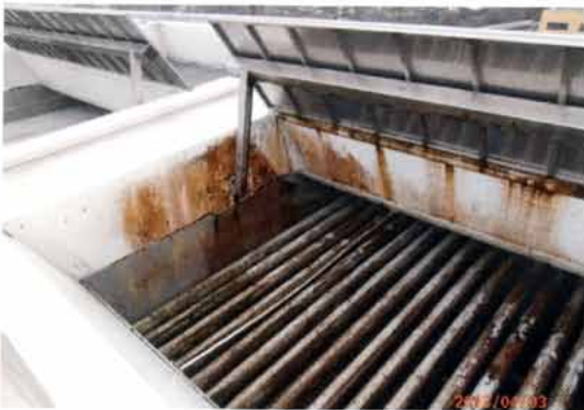
Starke Ablagerungen am Abluftauslass eines Rückkühlwerkes
