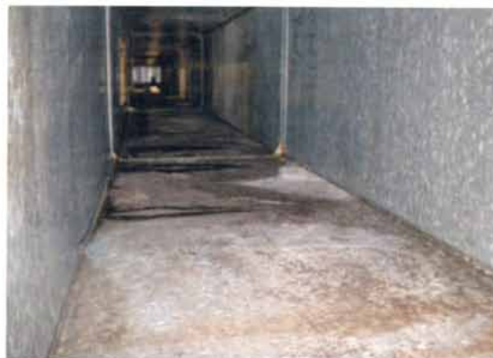
Luftleitungssystem nach der hygienischtechnischen Behandlung
