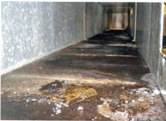
Deutliche Verschmutzung in einem Luftleitungssystem
