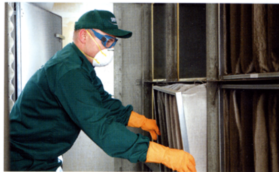
Fachgerechter Ausbau verschmutzter Filter, die für Lebensmittelbetriebe hohe Hygienrisiken bergen
