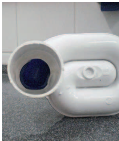
◀ Geruchsverschluss Urinal – links mit starken Ablagerungen und Inkrustierungen, rechts nach der tiefenhygienischen Behandlung
