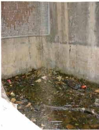
Bereich Außenluftansaugung einer RLT-Anlage. Mangelnde Reinhaltung des direkten Umfelds und bauliche Mängel können zu einer Beeinträchtigung der Zuluftqualität führen.
