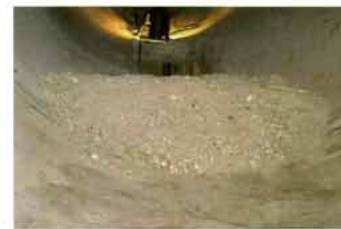
Bevor die Anlage nach einer Inspektion, Kontrolle oder Wartung und Instandhaltung wieder in Betrieb genommen wird, ist sie „besenrein“ zu hinterlassen.
