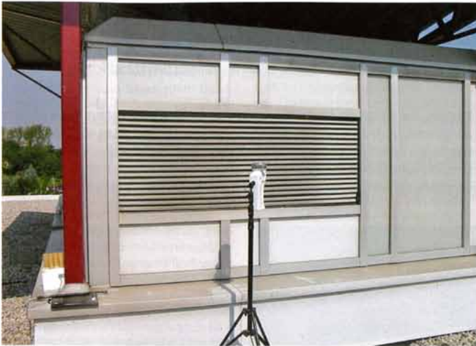
Luftkeimmessung im Bereich der Außenluftansaugung.
