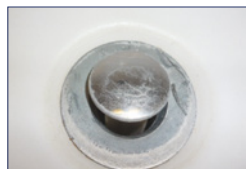
Eine häufige Keimquelle im Abwasserbereich: der Waschbeckenabfluss.
