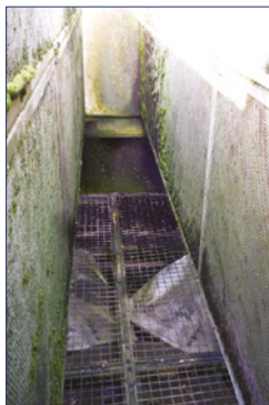
Kontaminationsweg – über die Dach-Schalldämpfer eines Kühlturms.
