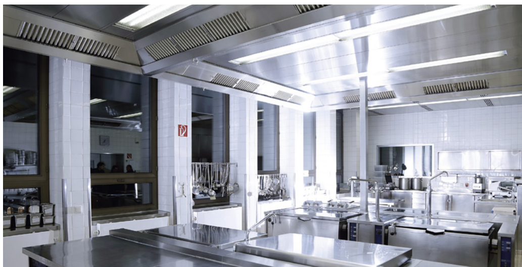
Hygienische Verhältnisse in der gewerblichen Küche hängen auch mit dem Zustand der Küchenlüftung zusammen.
